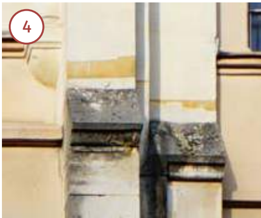
Recouvrements biologiques sur les chape- rons des contreforts
