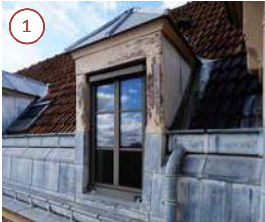
Couvertures en zinc dégradées
